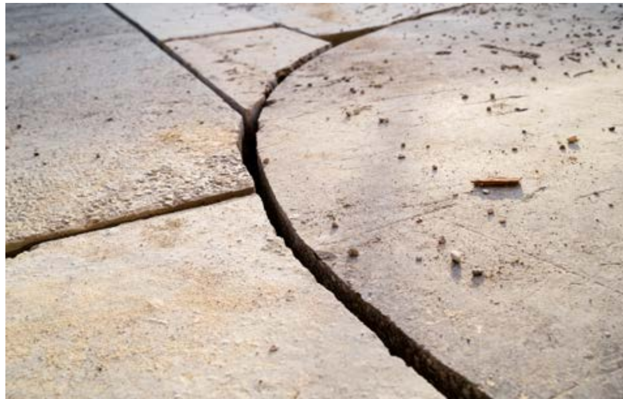
Dallage de réemploi au stade des Arbères à Meyrin par FAZ architectes Wiederverwendete Bodenplatte im Stade des Arbères in Meyrin von FAZ architectes
